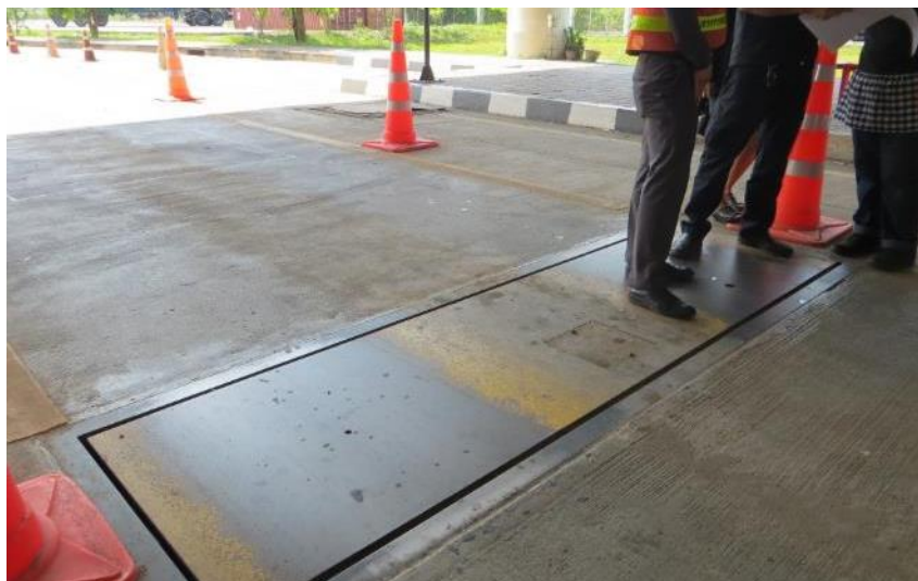
รูปที่ 8.24 เครื่องชั่งน้ำหนักบริเวณประตูเข้าออกด่านพรมแดนนครพนม
