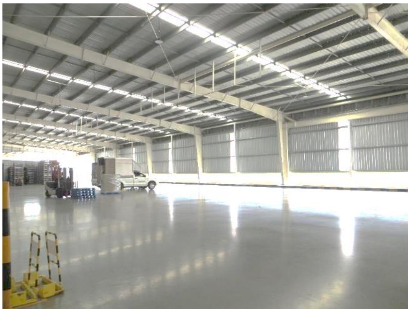
รูปที่ 6.22 ชานชาลาที่สามารถนำรถยนต์ 4 ล้อขึ้นมาจอดรับสินค้าบนชานชาลา
