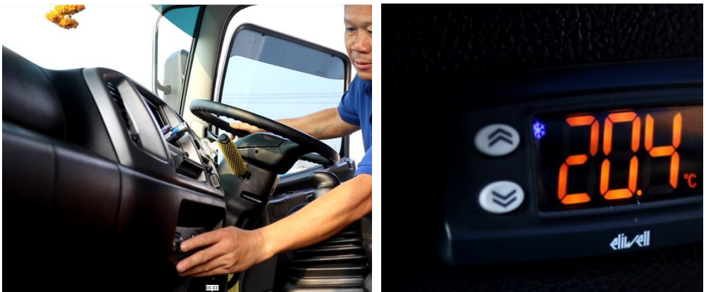
รูปที่ 4.22 การติดตั้งหน้าจอแสดงผลอุณหภูมิแบบดิจิทัลภายในห้องคนขับ
