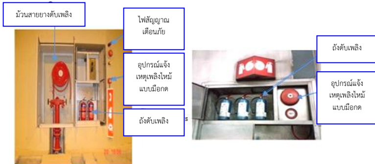
ภาพอุปกรณ์ดับเพลิงและอุปกรณ์เตือนภัยในอุโมงค์
